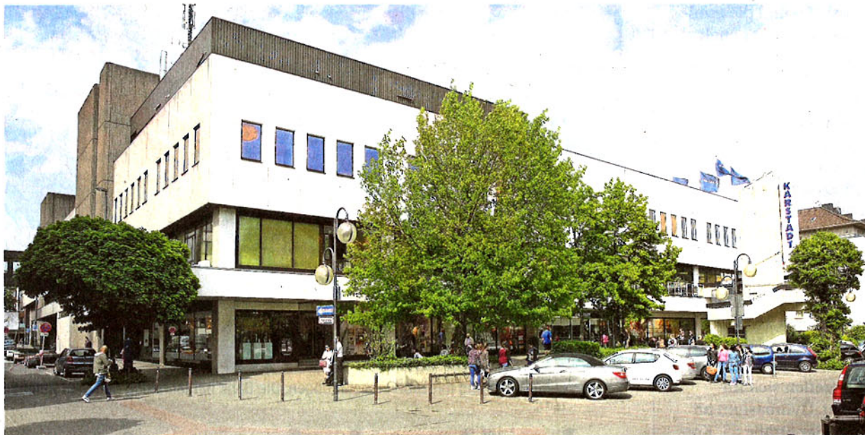
Das Karstadtgebäude wurde 2015 von der EWMG gekauft und wird derzeit umgebaut. Noch bietet es eine Restmietfläche von 360 Quadratmetern. Foto: Andreas Baum
